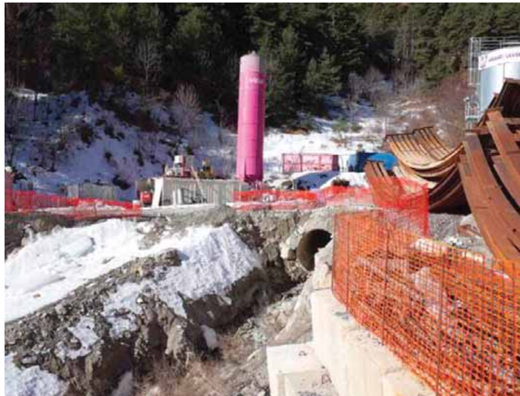
Il piazzale di cantiere che ostruisce l'alveo del Rio della Cà, intubato. (Fig. 16)
